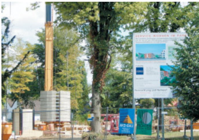
Noch regieren Kran und Kelle: An der Stieghorster Straße 70 entsteht ein Mehrgenerationenhaus mit 60 Wohnungen.
